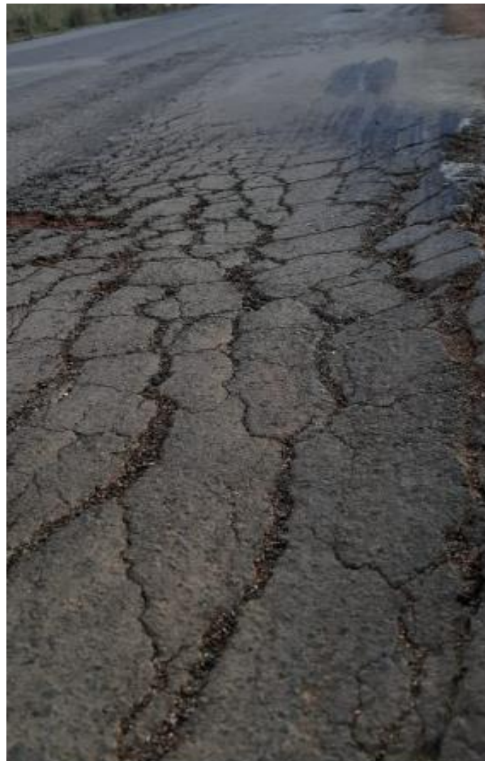
Figura 18: Patologia tipo trinca – Rodovia – 257
