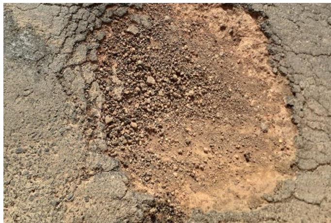
Figura 10: Patologia tipo panela/buraco – Rodovia - 257
