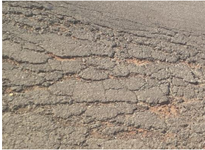
Figura 17: Patologia tipo trinca – Rodovia – 257
