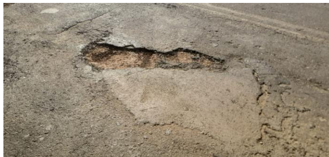
Figura 12: Patologia tipo panela/buraco – Rodovia - 257
