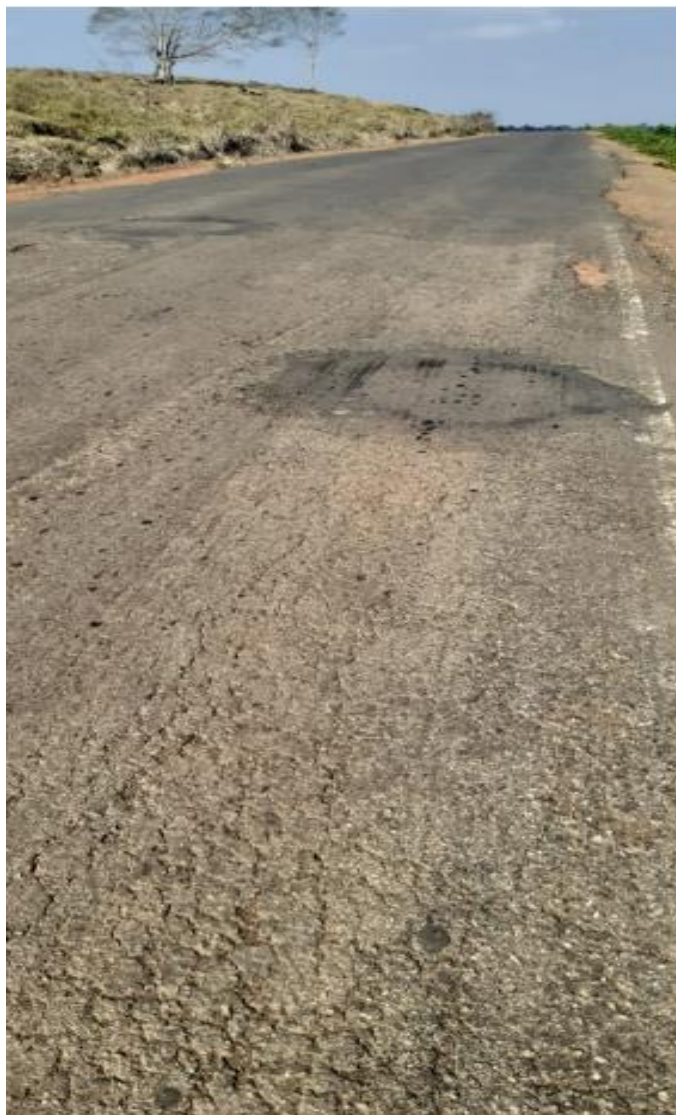
Figura 22: Patologia tipo Remendo - Rodovia – 257
