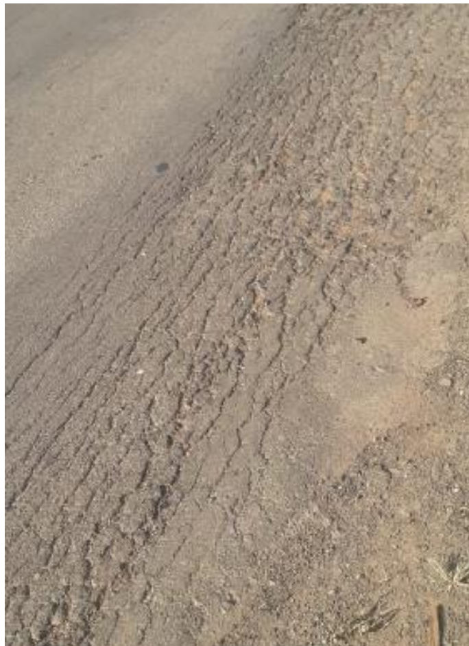
Figura 16: Patologia tipo trinca – Rodovia – 257
