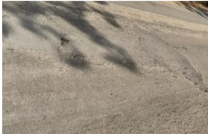
Figura 19: Patologia tipo Remendo - Rodovia – 257
