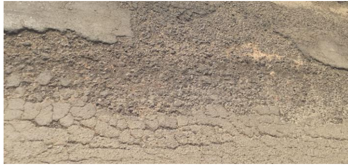
Figura 13: Patologia tipo desgaste Rodovia – 257
