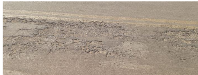
Figura 14: Patologia tipo desgaste Rodovia – RO257
