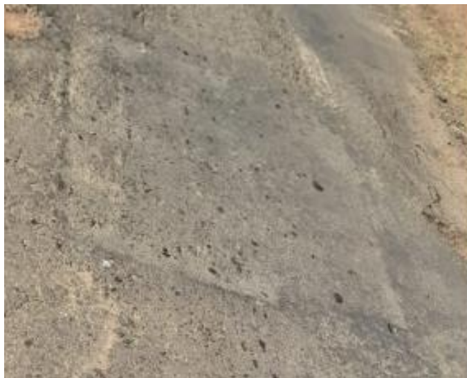
Figura 20: Patologia tipo Remendo - Rodovia – 257
