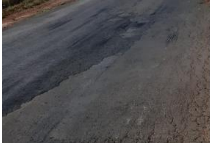
Figura 21: Patologia tipo Remendo - Rodovia – 257
