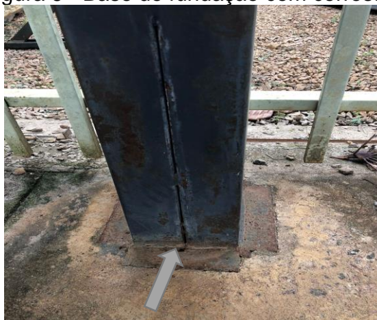
Figura 6 - Base de fundação com corrosão
