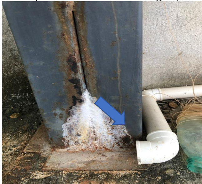
Figura 7 - Base pilar com escoamento de água (Eflorescência)
