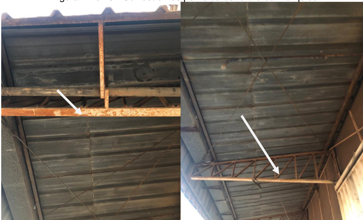
Figura 14 e 15 - Corrosão nos perfis da estrutura da marquise
