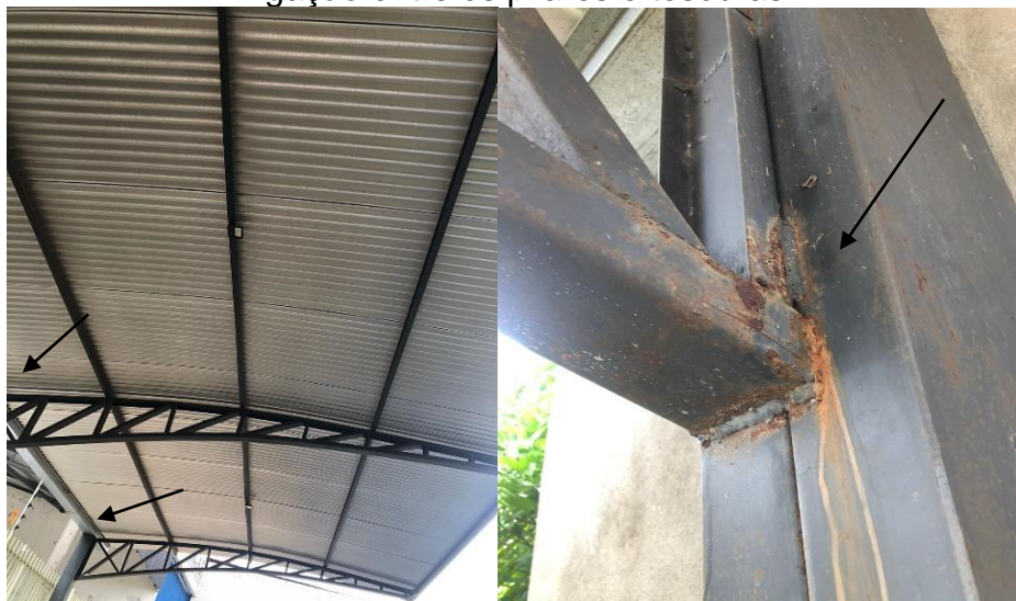
Figura 9 e 10 - Corrosão nas extremidades da estrutura metálica e na solda da ligação entre os pilares e tesouras
