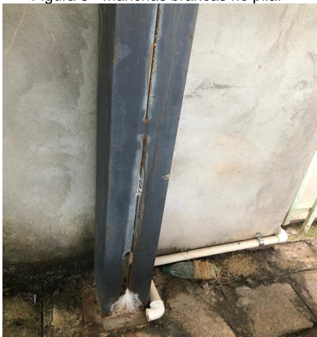
Figura 8 - Manchas brancas no pilar
