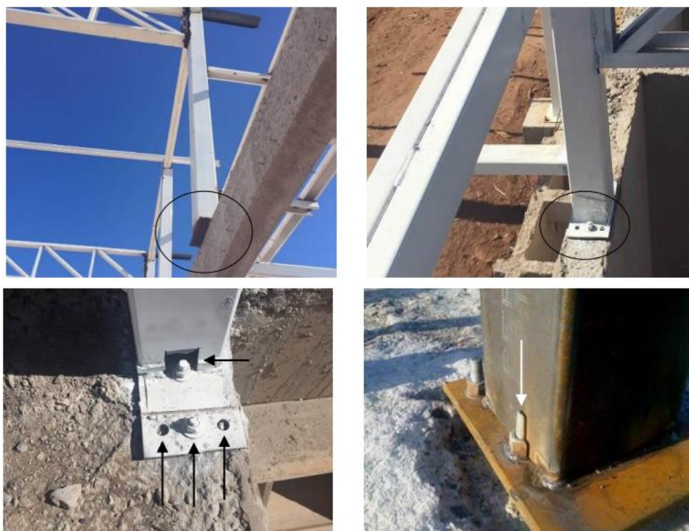
Figura 2 - Falhas em construções metálicas resultantes de erros ou incompatibilidade de projetos
