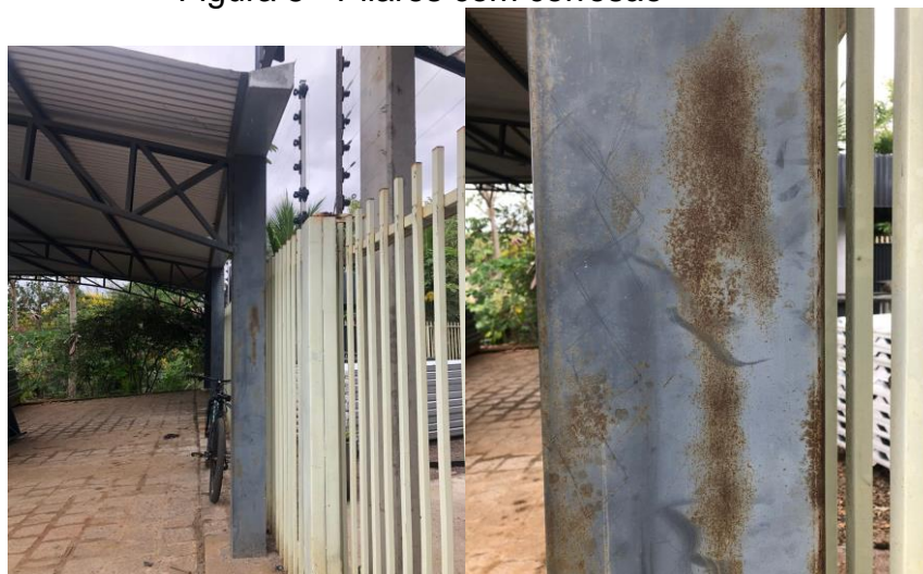
Figura 5 - Pilares com corrosão
