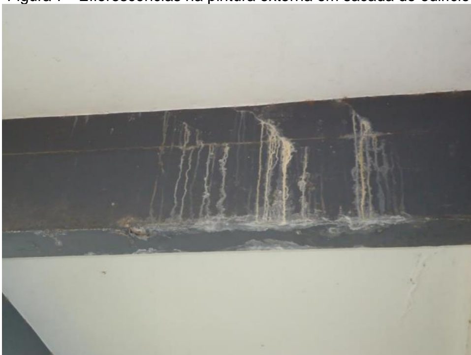
Figura 7 - Eflorescências na pintura externa em sacada do edifício
