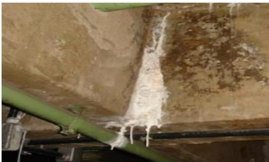
Figura 8 - Eflorescência devido a umidade
