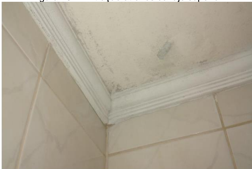
Figura 10 - Infiltração através da laje superior
