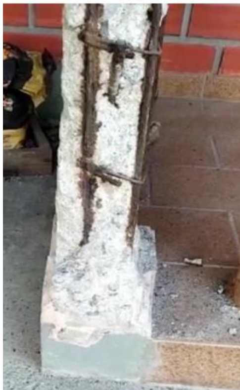
Figura 11 - Corrosão da armadura no pilar
