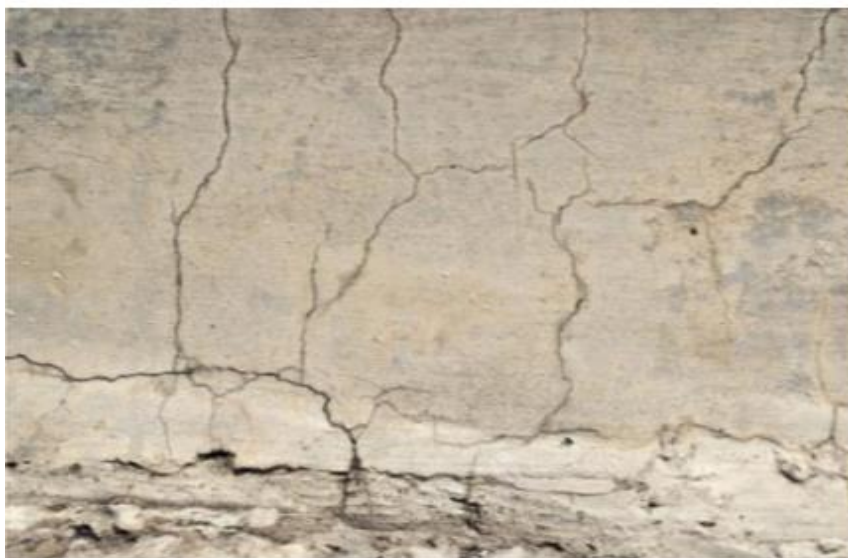
Figura 5 - Representação de trinca generalizada no reboco
