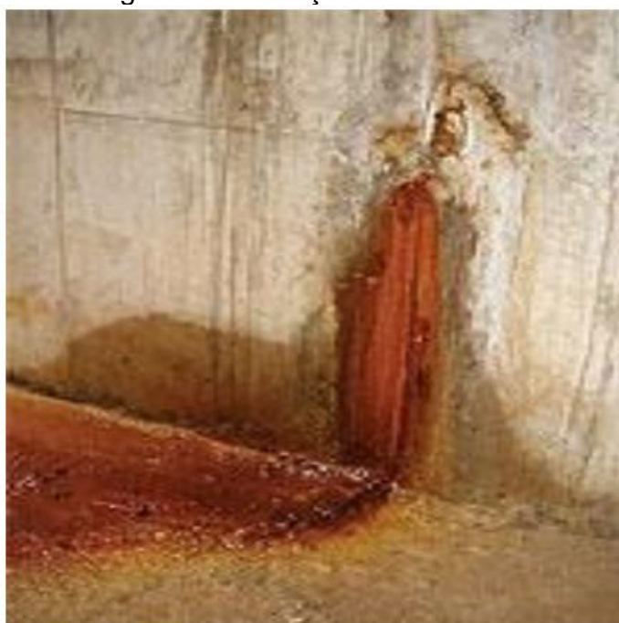
Figura 9 - Infiltração em subsolo
