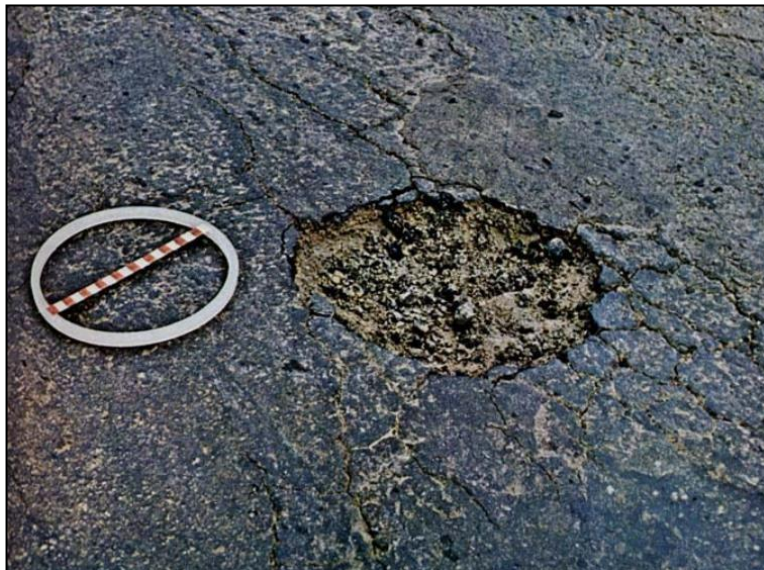
Figura 13 – Patologia asfáltica: Panela ou buraco
