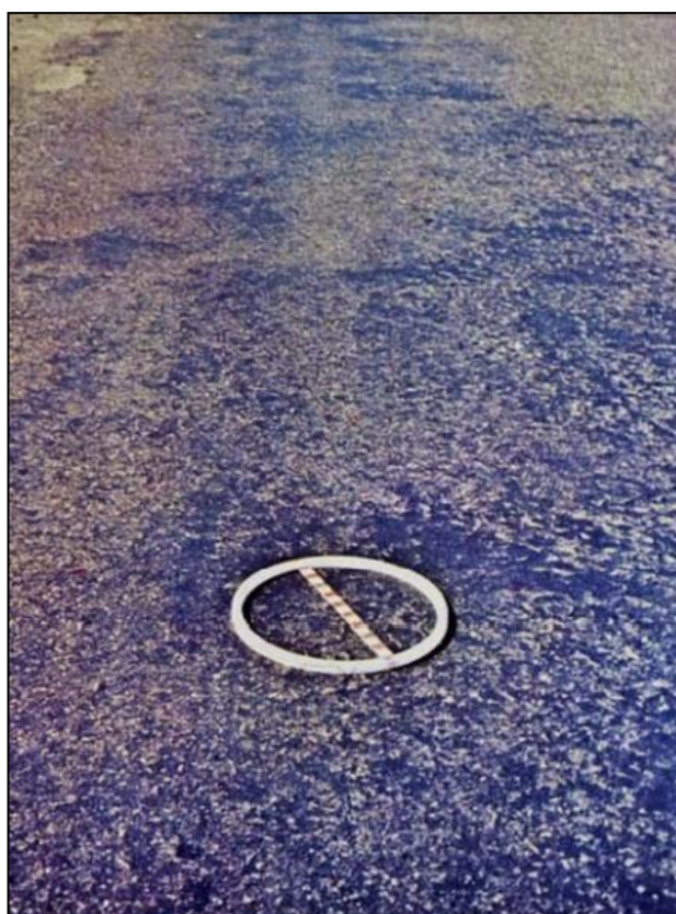
Figura 12 – Patologia asfáltica: Exsudação
