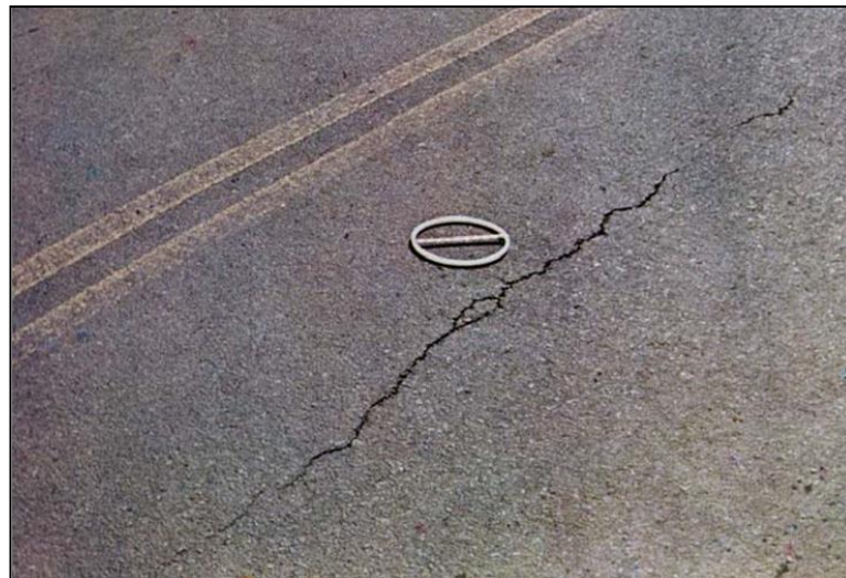
Figura 7 – Patologia asfáltica: Trinca isolada
