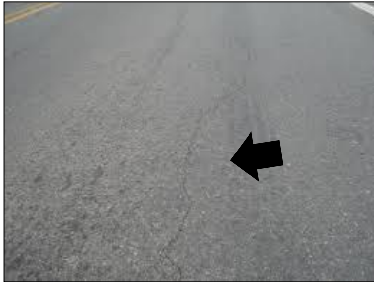
Figura 6 – Patologia asfáltica: Fissura
