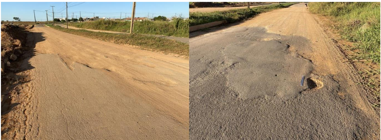
Figura 26 – Falhas pavimentação Trecho A
