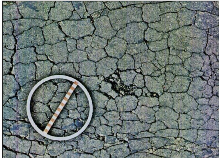
Figura 8 – Patologia asfáltica: Trinca interligada
