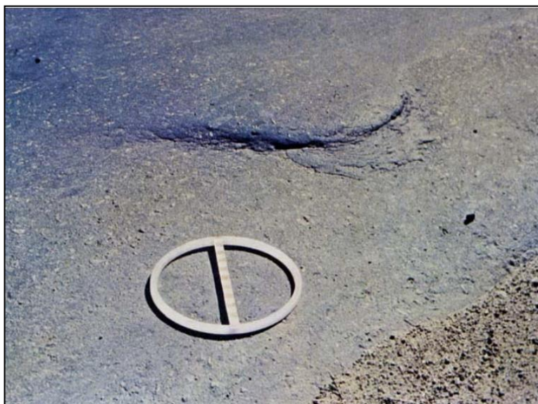
Figura 11 – Patologia asfáltica: Escorregamento
