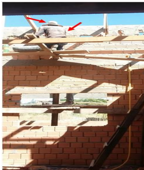
Fig. 04 – Inconformidade referente ao uso de EPI em trabalho em altura na obra 02
