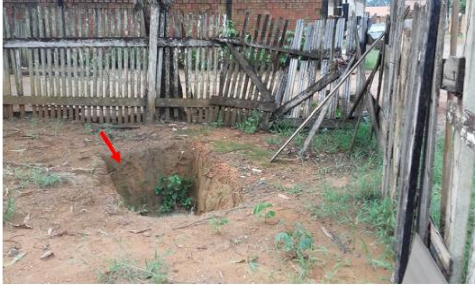
Fig. 06 – Buraco a céu aberto sem proteção na obra 03
