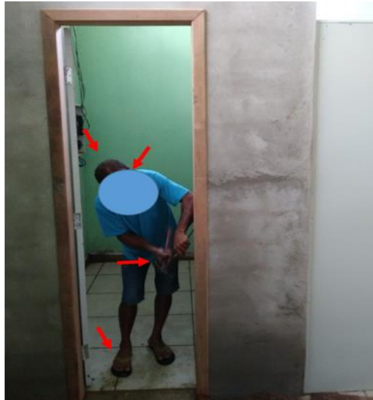
Fig. 03 – Inconformidade referente ao uso de EPI na obra 01
