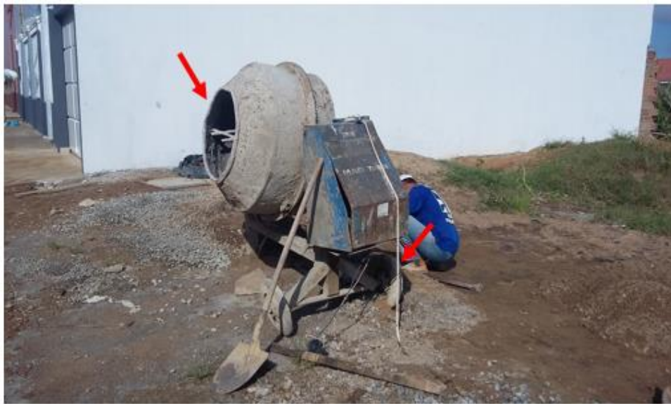
Fig. 05 – Inconformidade referente a manutenção e instalação elétrica de equipamento na obra 03
