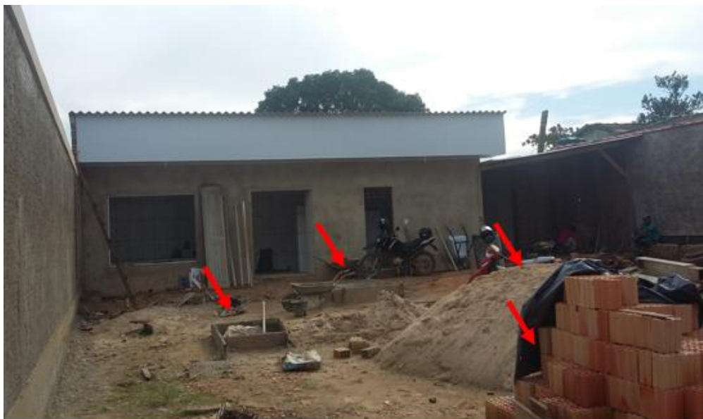
Fig. 07 – Canteiro de obra com falha em sua organização na obra 01
