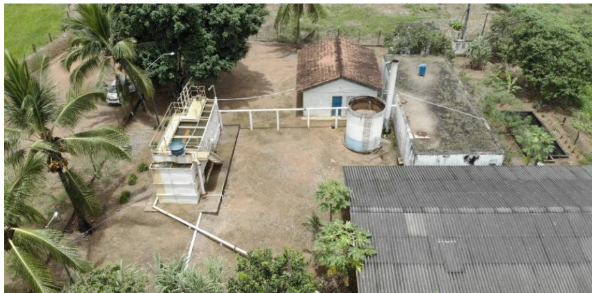
Figura 14 - Estação de tratamento de água da Cidade de Campo Novo de Rondônia
