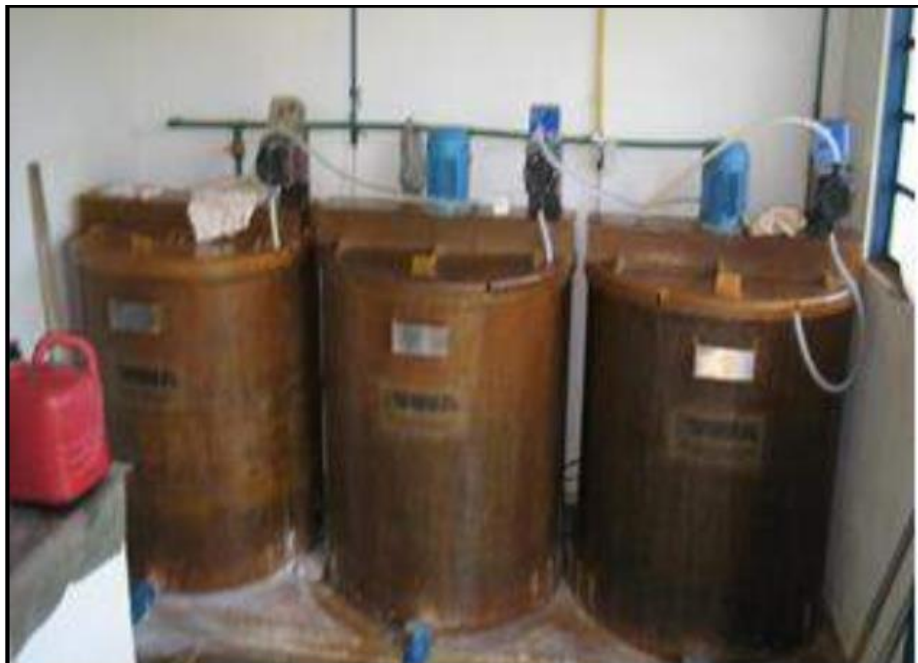
Figura 20 - Tanques de mistura de sulfato de alumínio, cloro e cal
