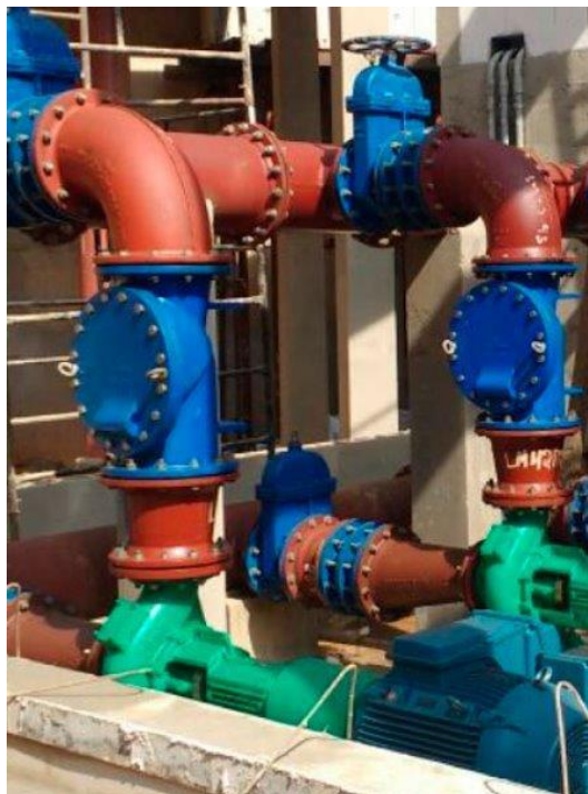
Figura 7 - Elevatória de água tratada
