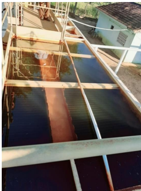
Figura 22 - Sistema de Tratamento
