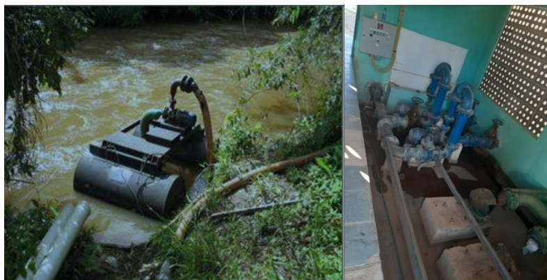
Figura 16 - Estação de bombeamento
