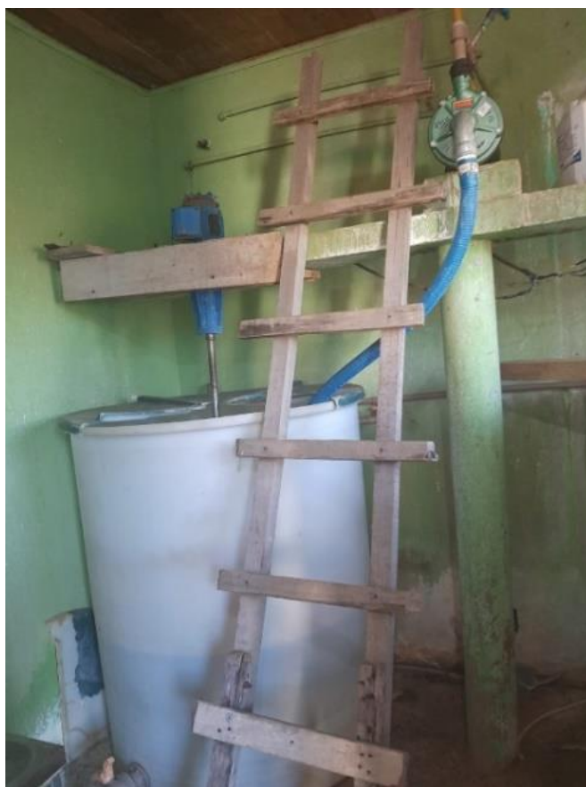
Figura 18 - Tanque de mistura de coagulante
