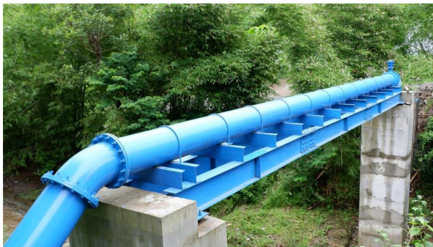
Figura 4 - Adutora de sistema de tratamento de água
