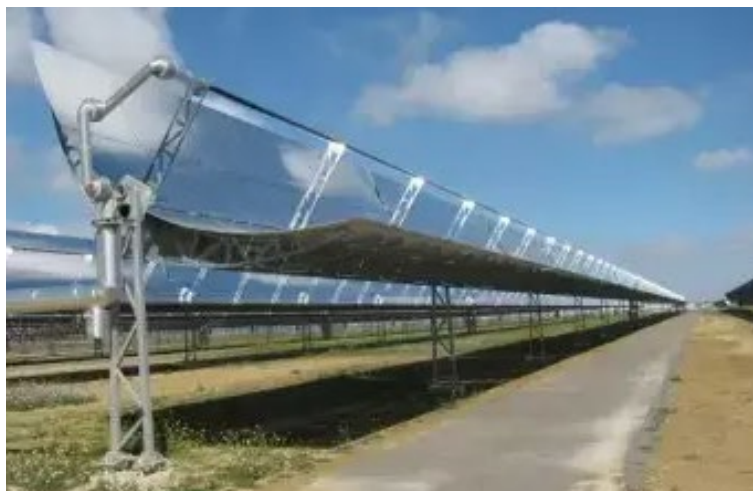
Figura 8 – Usina com painéis concentradores solares
