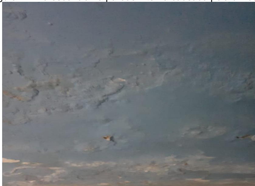
Figura 7- Eflorescência na parede interna causada pela umidade.
