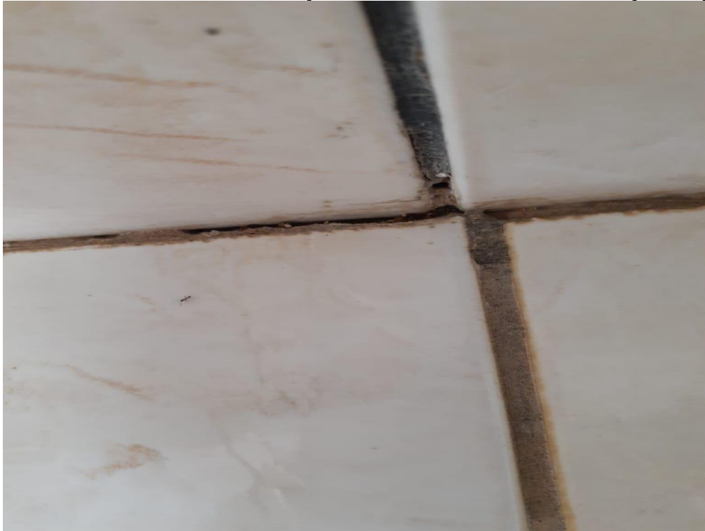
Figura 11 – Piso interno de edificação com ocorrência de deterioração de junta
