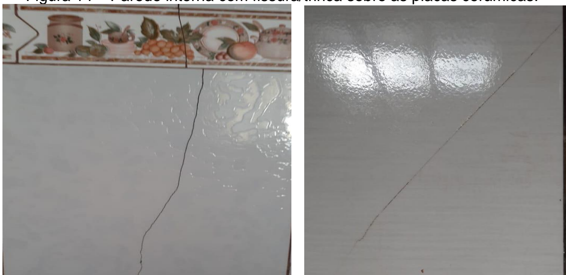
Figura 14 – Parede interna com fissura/trinca sobre as placas cerâmicas.
