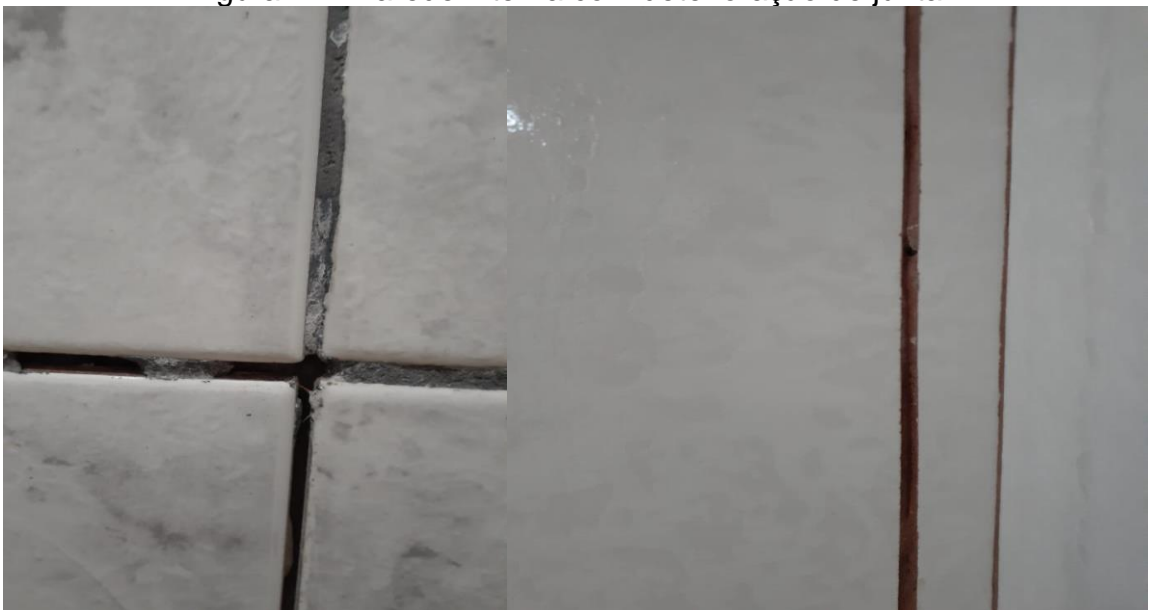
Figura 12 - Parede interna com deterioração de junta
