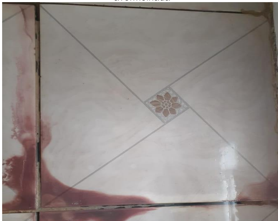
Figura 10 - Parede em revestimento cerâmico com mancha de água com tonalidade avermelhada
