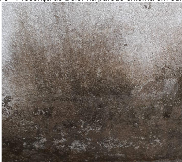
Figura 8 - Presença de Bolor na parede externa em edificação
