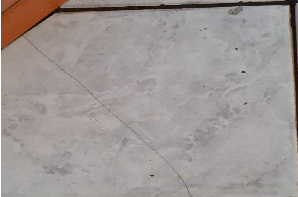
Figura 13 - Piso caracterizando fissura sobre a superfície do revestimento cerâmico
