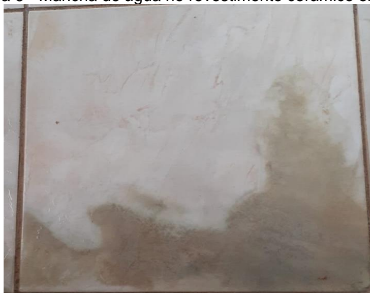
Figura 6 - Mancha de água no revestimento cerâmico em piso
