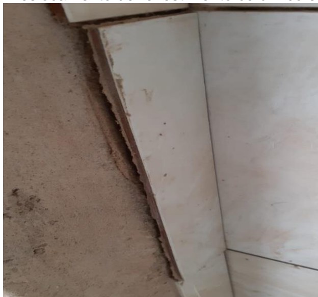
Figura 4 - Deslocamento de revestimento cerâmico em parede
