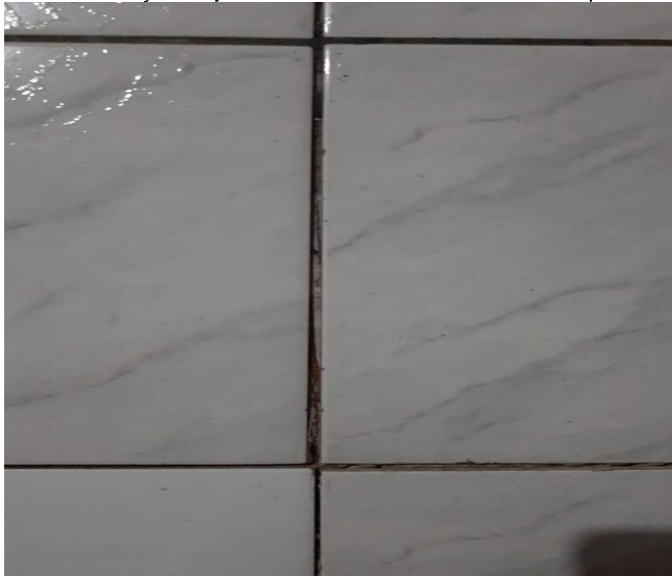
Figura 3 - Deterioração de juntas de revestimento cerâmica em parede interna
