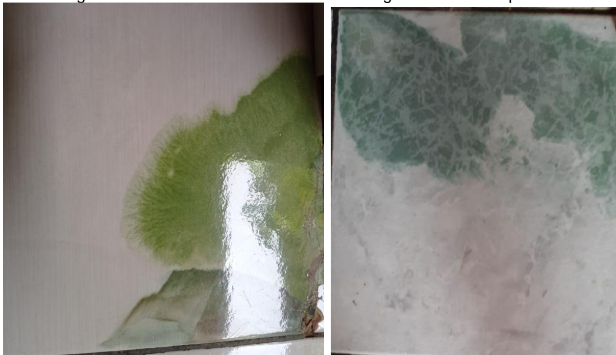
Figura 9 - Piso cerâmico com manchas de água sobre sua superfície
