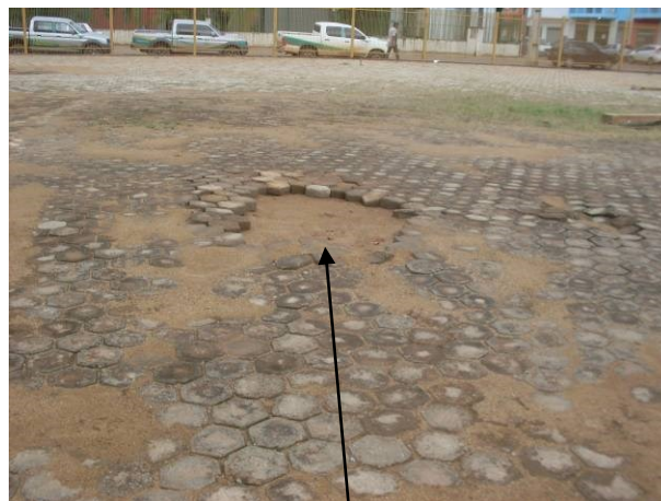
Foto 4- Piso em bloquete de concreto defeituoso.
