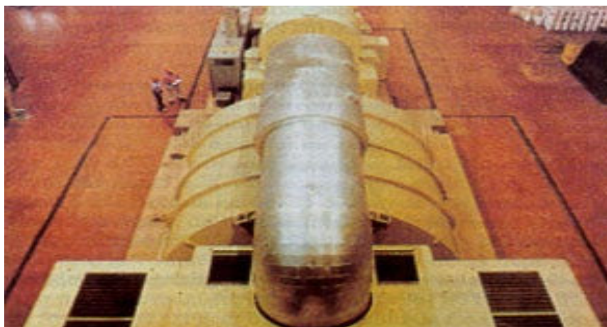
Figura 10. Dínamo de uma usina hidroelétrica.
