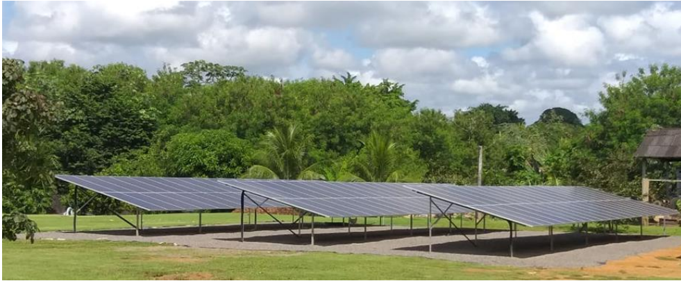
Figura 4 - Placas fotovoltaicas instaladas no solo
