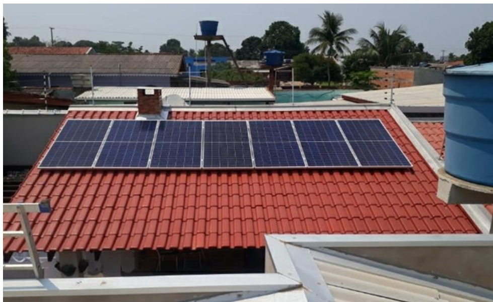
Figura 3 - Placas fotovoltaicas instaladas em cobertura
