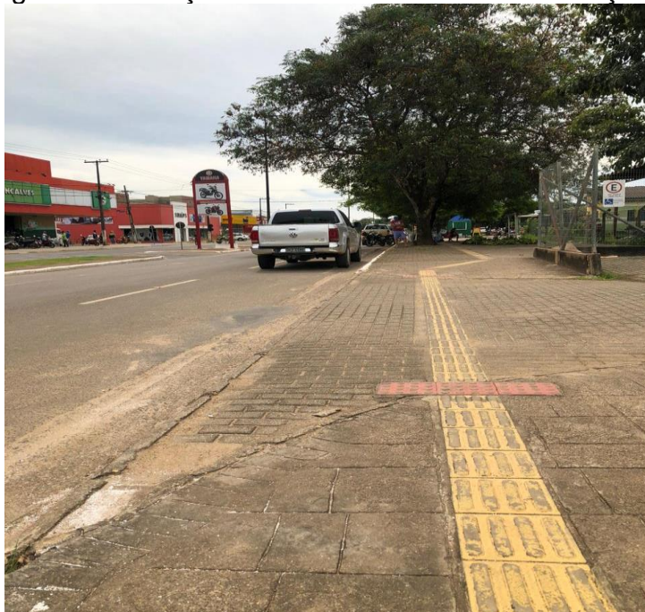
Figura 27 – Calçada em mal estado de conservação
