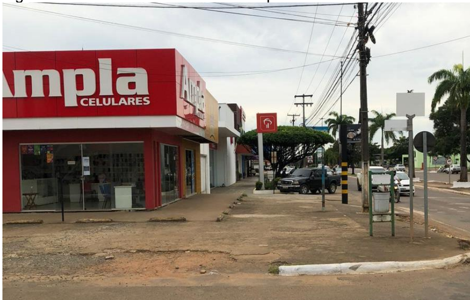
Figura 39 – Passarela em frente a Ampla Celulares danificada
