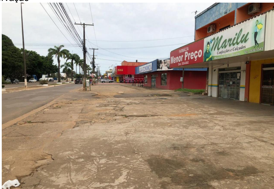
Figura 44 - Quadra entre a Travessa Samaúma e Travessa Maracatiara em mal estado de conservação
