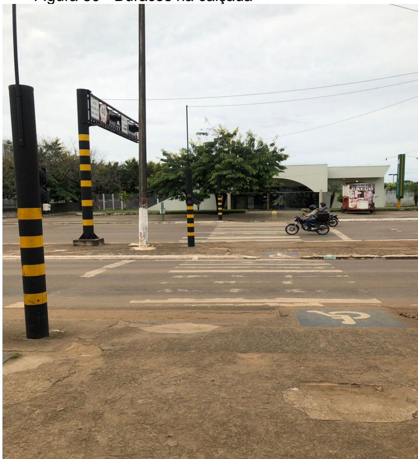
Figura 30 - Buracos na calçada
