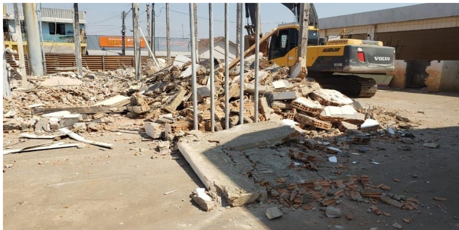
Figura 6 - Amontoamento de RCD
