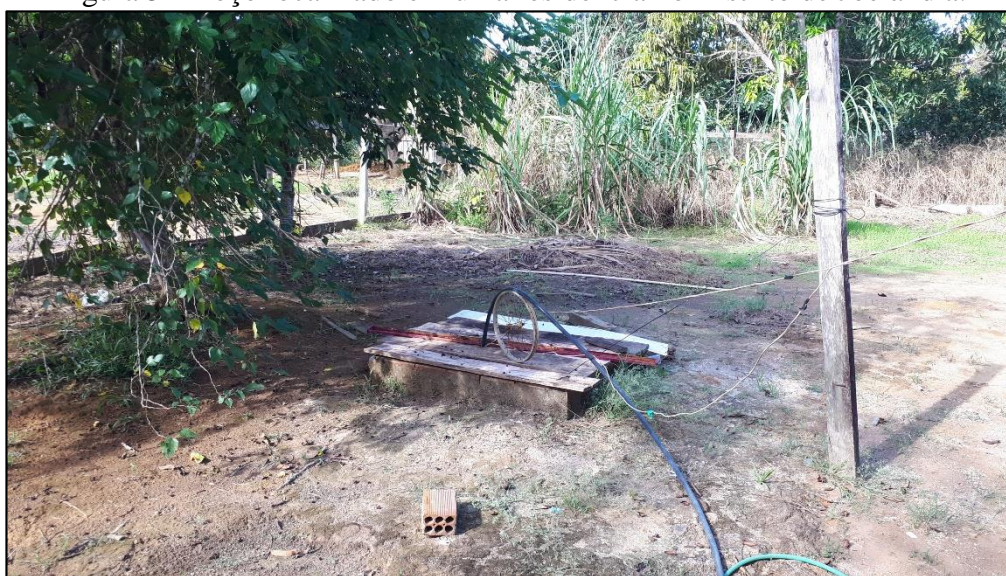
Figura 5 – Poço localizado em uma residência no Distrito de Joelândia.
