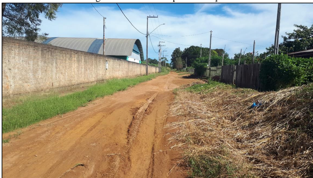
Figura 10 – Rua sem pavimentação.
