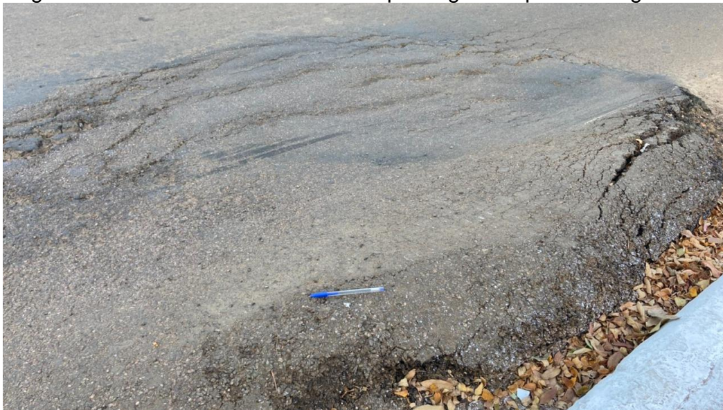
Figura 15 - Avenida Tancredo Neves: patologia do tipo escorregamento
