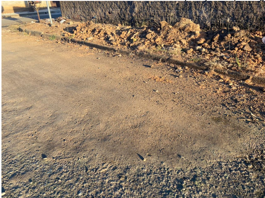
Figura 43 - Local onde foi realizado o estudo de recuperação da patologia panela
