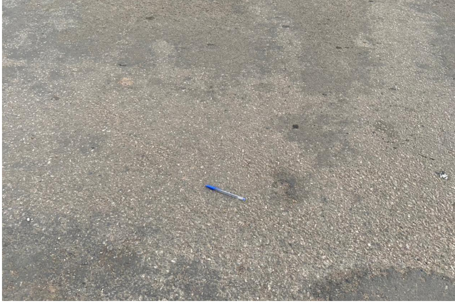
Figura 11 - Avenida Canaã: patologia do tipo desgaste
