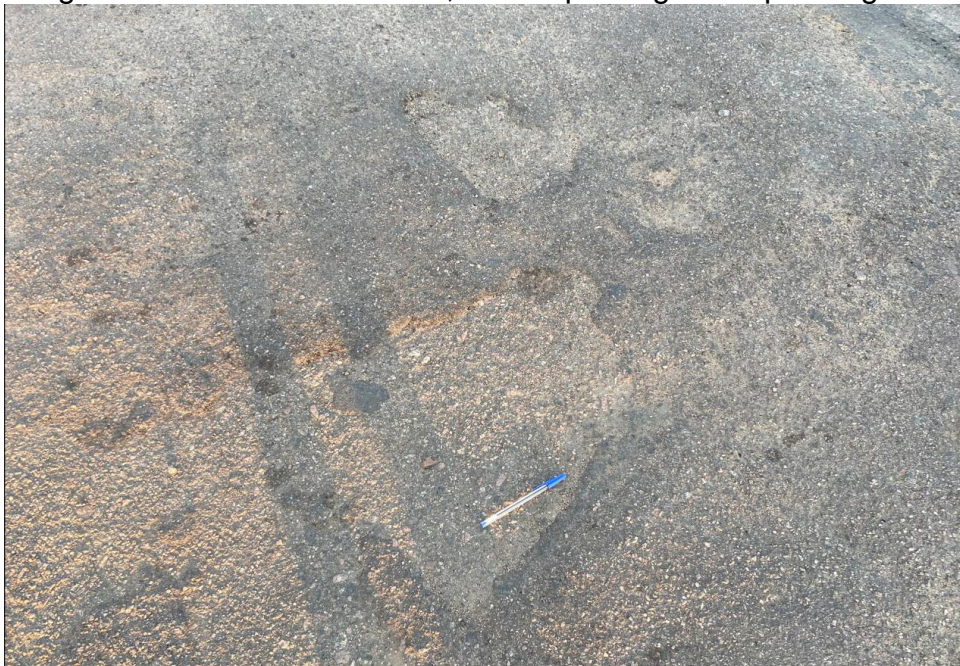
Figura 12 - Rua Mato Grosso, St. 05: patologia do tipo desgaste
