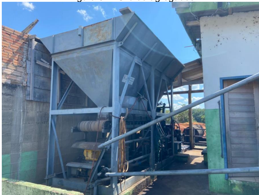
Figura 34 - Silo de agregados
