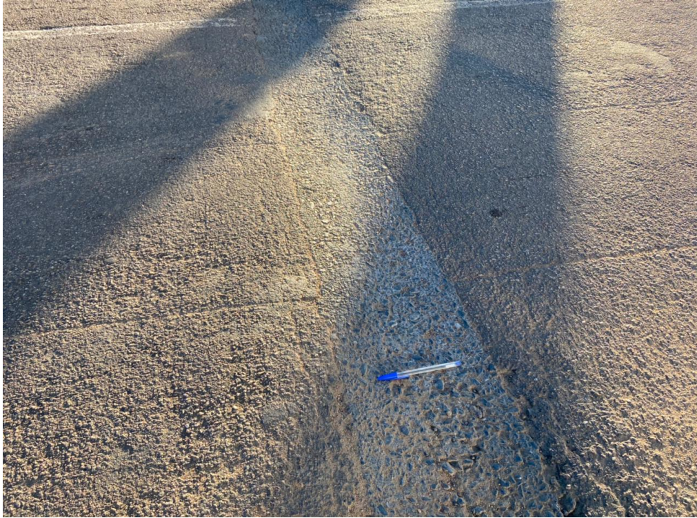
Figura 8 - Rua Acácia, St. 01: patologia do tipo afundamento
