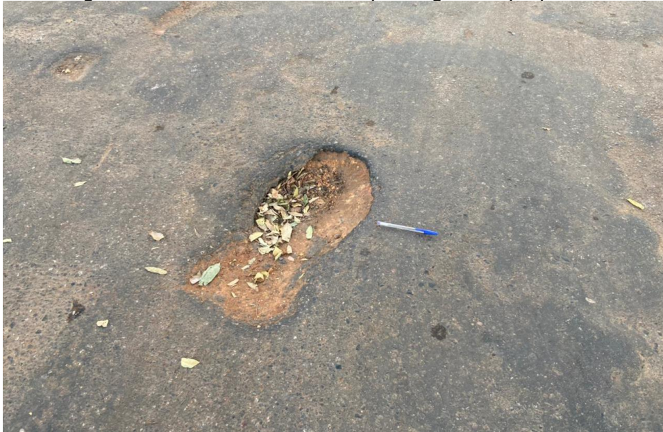
Figura 18 - Avenida Candeias: patologia do tipo panela
