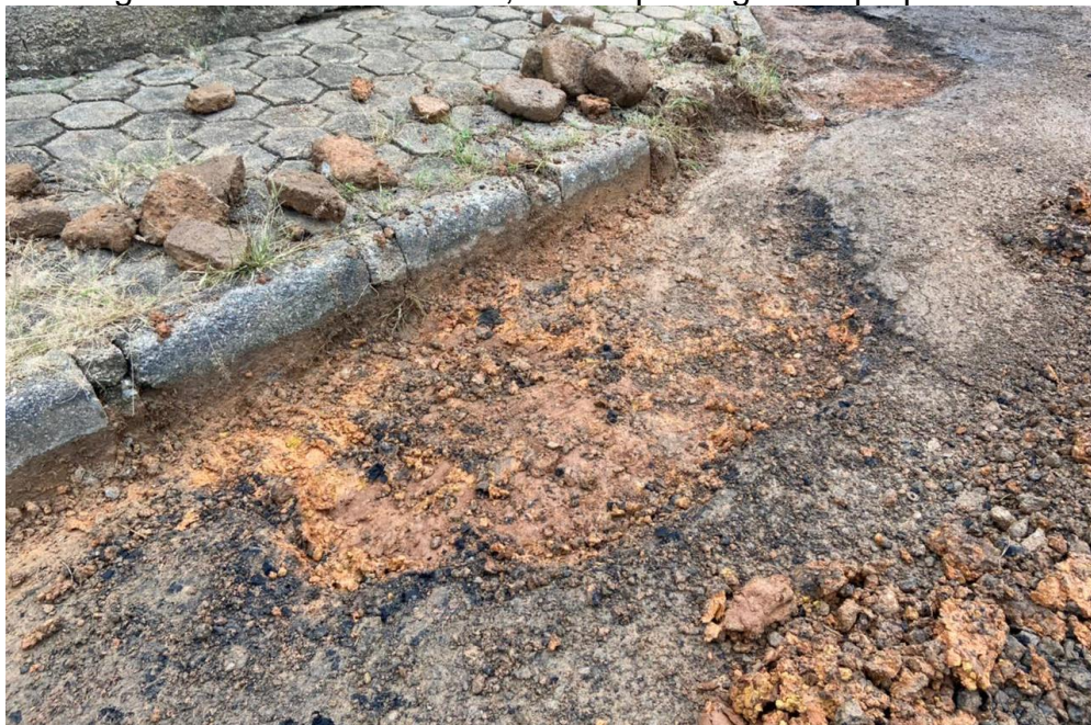
Figura 19 - Rua Tiradentes, St. 09: patologia do tipo panela
