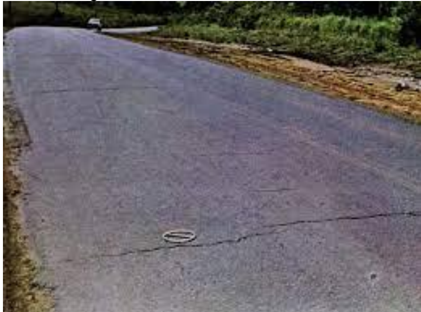
Figura 21 - Trinca isolada – transversal
