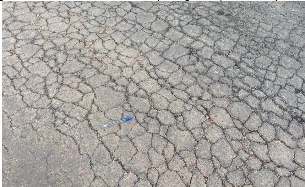
Figura 24 - Rua Castro Alves, St. 06: patologia do tipo couro de jacaré
