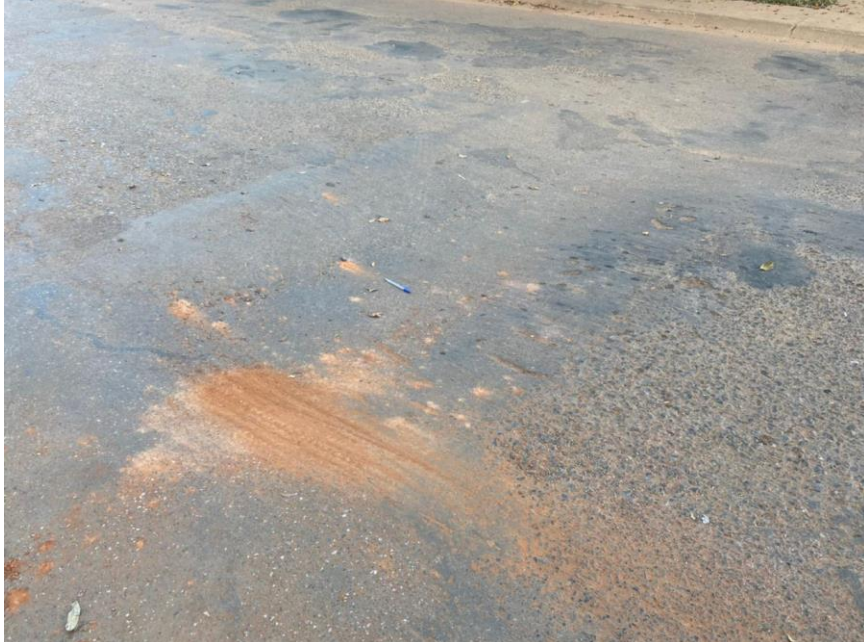
Figura 9 - Tv. Rio São João, St. Institucional: patologia do tipo afundamento
