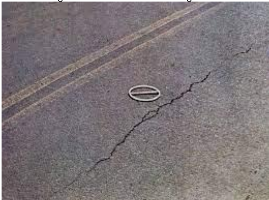
Figura 22 - Trinca isolada – longitudinal
