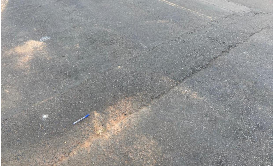
Figura 10 - Rua Curitiba, St. 03: patologia do tipo corrugação
