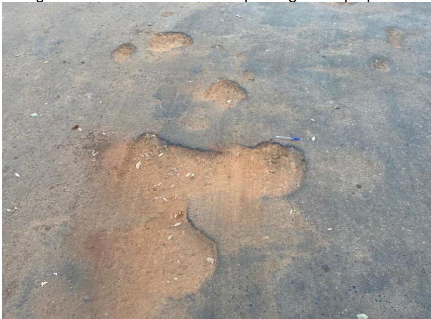
Figura 17 - Avenida Candeias: patologia do tipo panela
