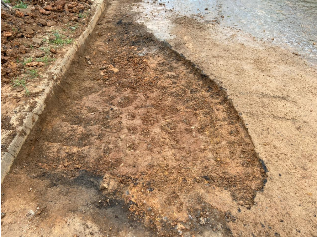
Figura 30 - Rua Tiradentes, St. 09: patologia do tipo panela
