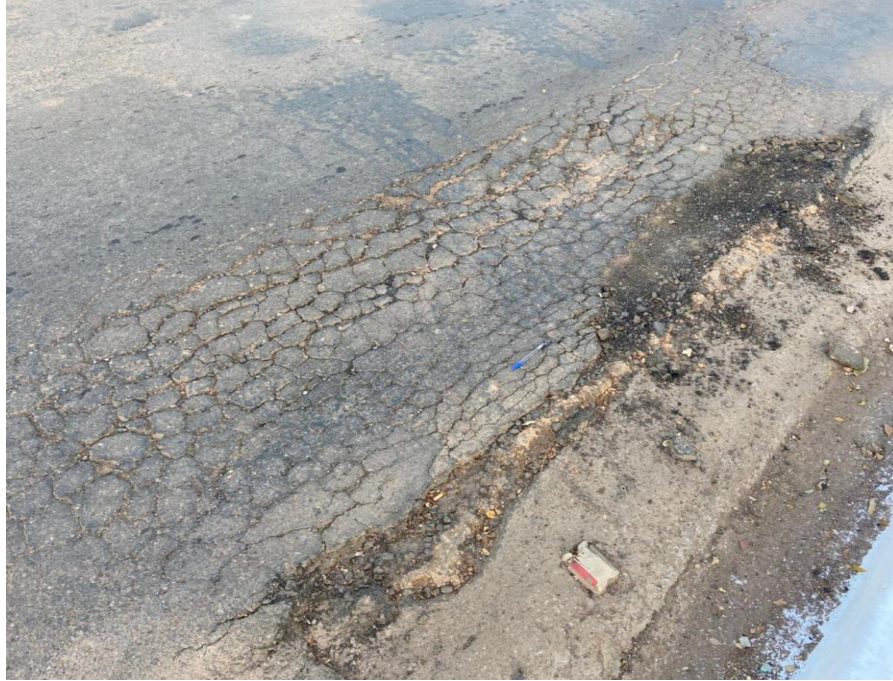
Figura 23 - Avenida Tancredo Neves: patologia do tipo couro de jacaré
