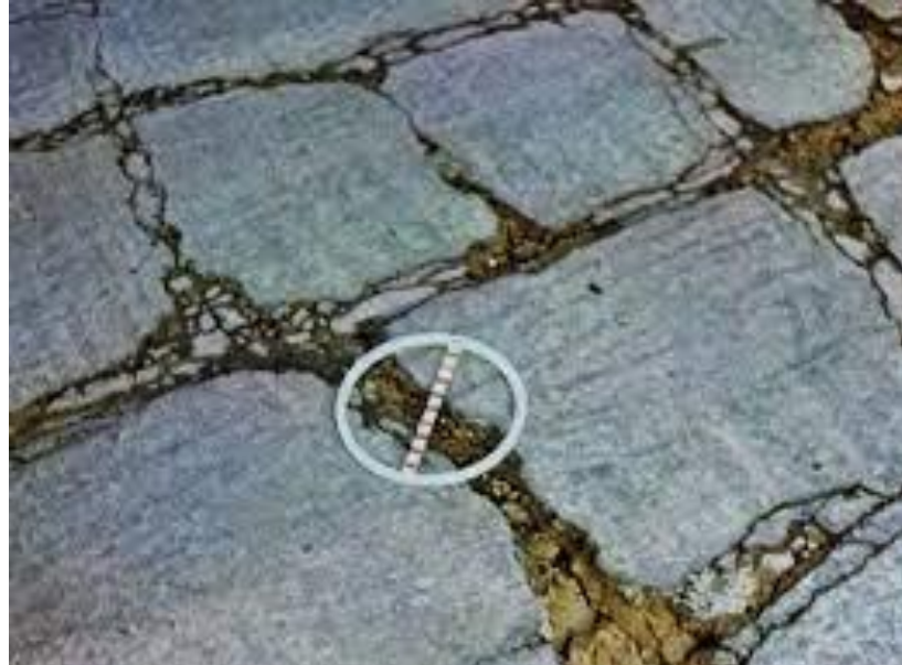
Figura 25 - Trinca interligada – tipo “bloco”
