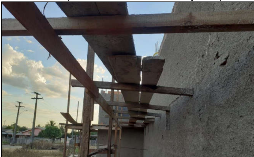
Figura 22 - Andaime improvisado da obra 3, com forração do piso incompleto.
