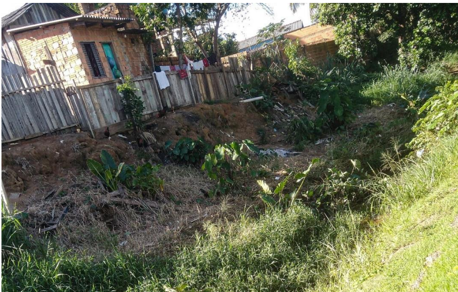
Figura 19 – Tubulação despejando direto no igarapé (Setor 02)
