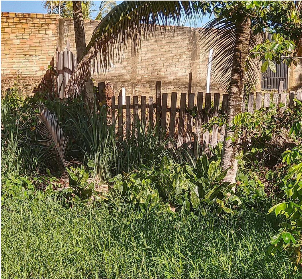
Figura 18 – Tubulação direto ao solo (Setor 02)
