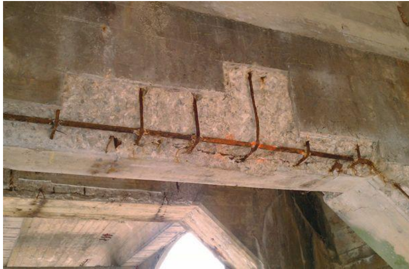
Figura 4 – Concreto atingido por manchas
