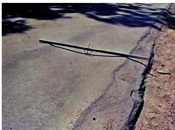
Figura 12 Afundamento de trilho de roda
