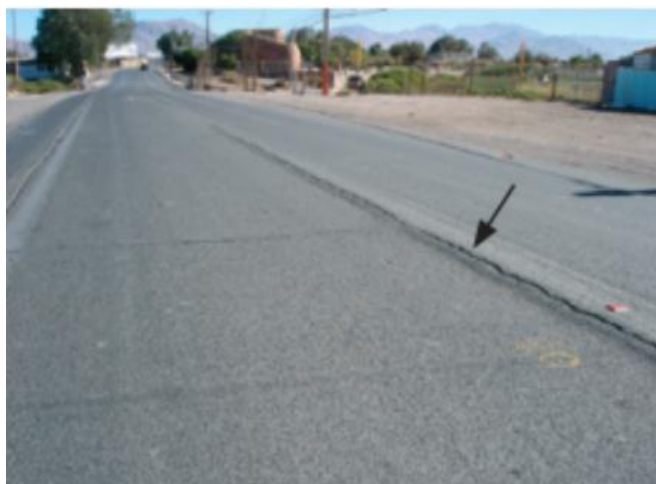
Figura 19 Trinca de retração
