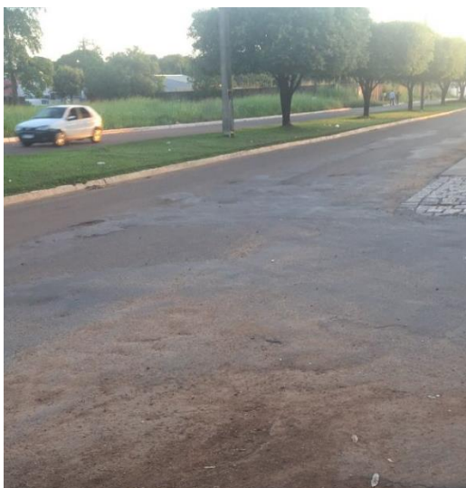
Figura 30 Remendos Trecho C
