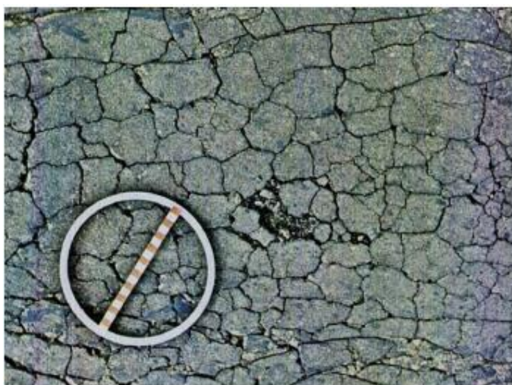
Figura 15 Trinca couro de jacaré
