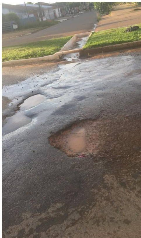
Figura 33 Painelas com água no Trecho C
