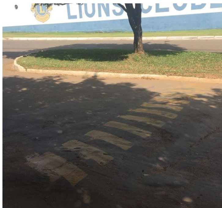
Figura 28 Patologias no quebra-molas do Trecho B
