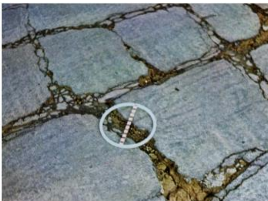
Figura 16 Trincas em bloco
