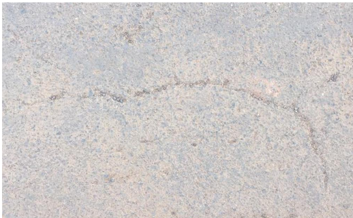
Figura 34 Trincas no Trecho C
