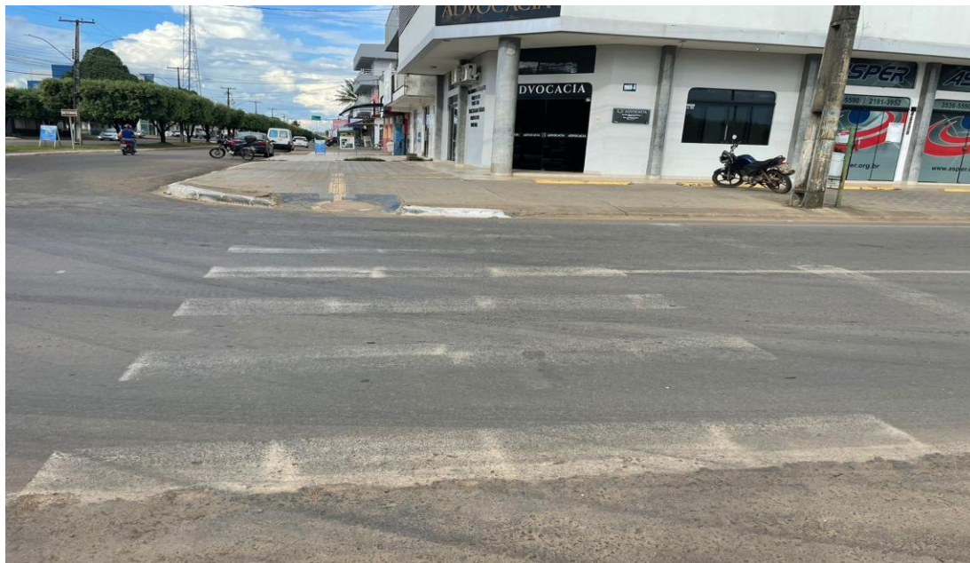
Figura 8 – Faixa de Pedestre em mau estado de conservação – JK sentido a Guaporé
