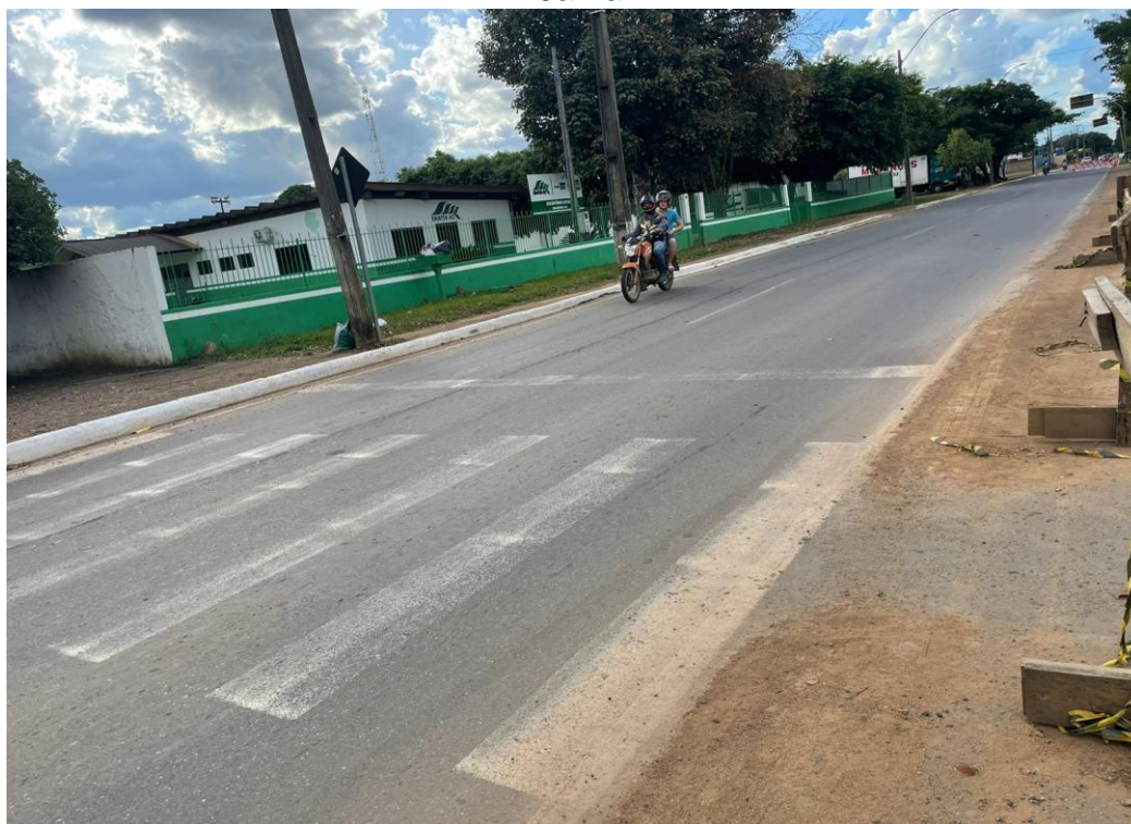
Figura 9 – Faixa de Pedestre em mau estado de conservação – JK sentido a Jamari
