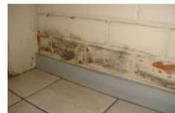
Revestimento com umidade
