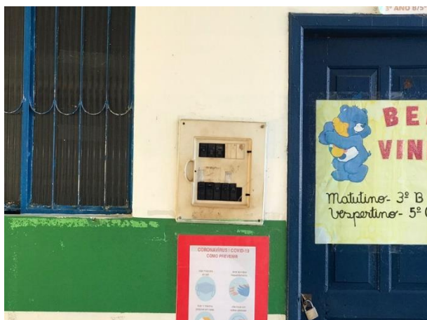
Figura 17 - Quadro de distribuição sem proteção
