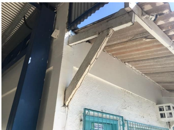
Figura 28 - Estrutura de madeira com cupins 01
