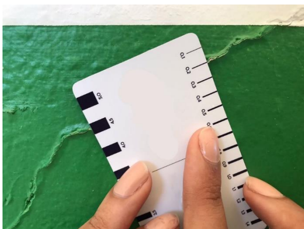
Figura 25 - Medição com fissurômetro 02
