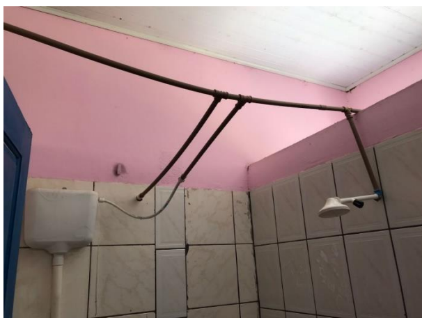
Figura 31 - Tubulação hidráulica aparente
