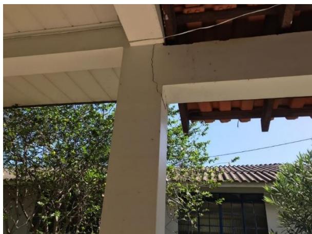
Figura 12 - Rachadura no encontro pilar/viga 01
