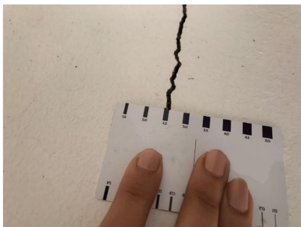
Figura 14 - Medição com fissurômetro 01
