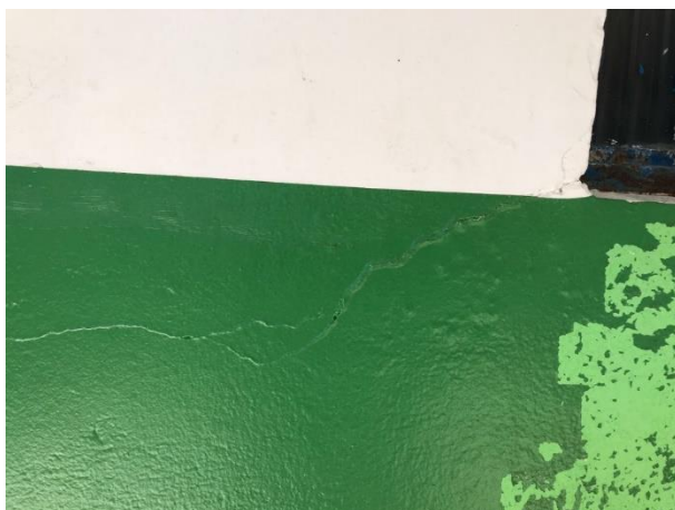
Figura 26 - Fissura em janela
