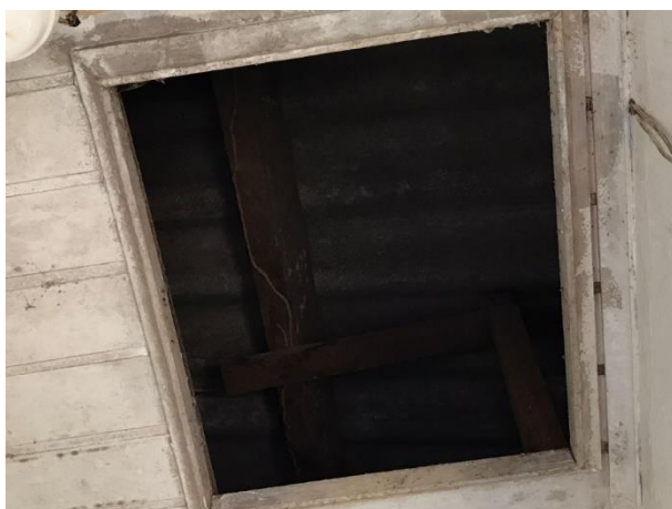
Figura 30 - Estrutura de madeira com cupins 03
