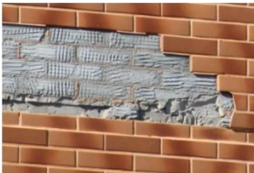
Figura 8 - Destacamento em fachada
