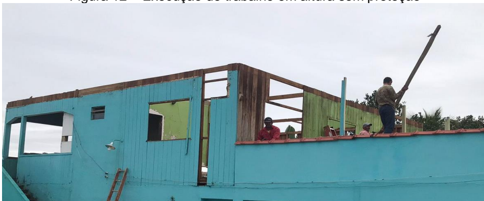
Figura 12 – Execução de trabalho em altura sem proteção
