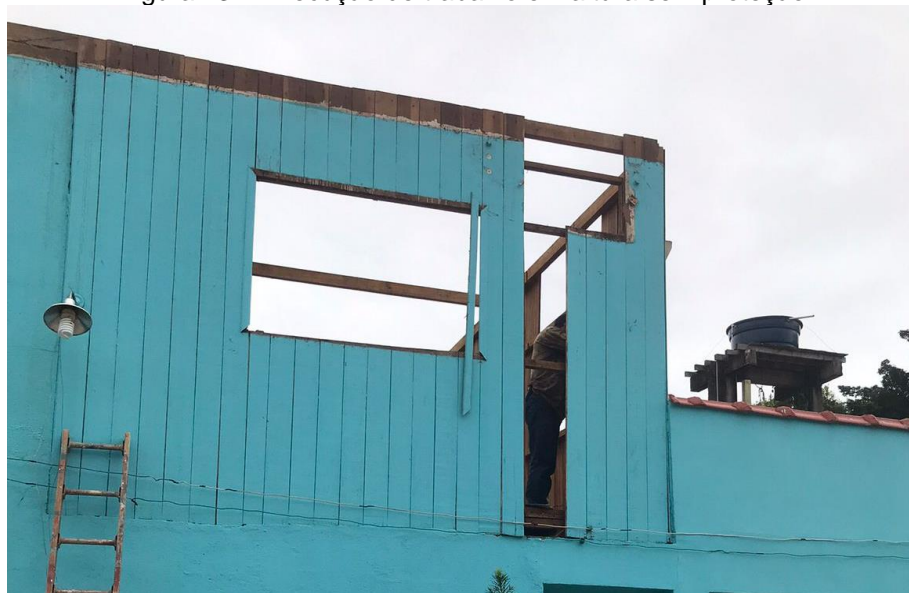
Figura 13 – Execução de trabalho em altura sem proteção
