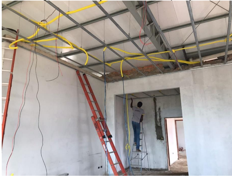
Figura 09 – Execução de trabalho sem proteção
