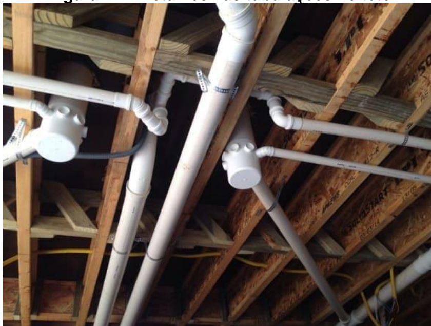
Figura 17 – Detalhes nas tubulações no teto
