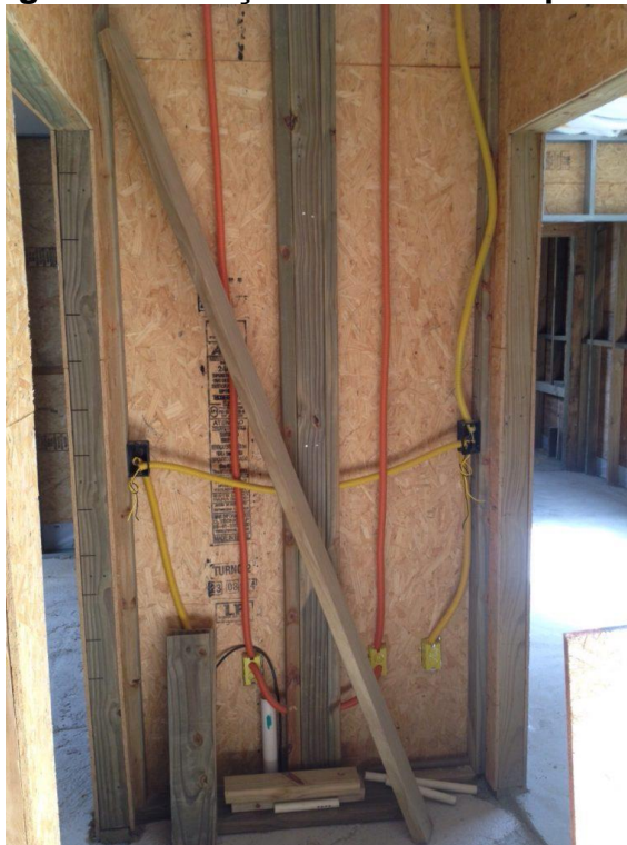
Figura 16 – Fiação no interior da parede
